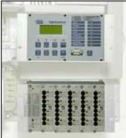
Original-Einbauten nach dem Brandversuch
